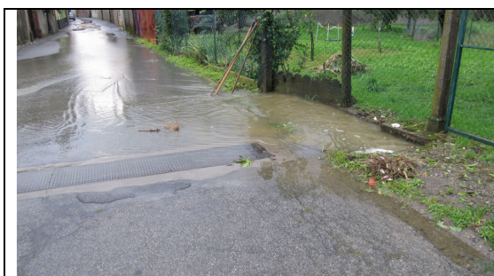
Foto n.5 – Le acque si riversano lungo via Vittorio Emanuele II a causa di una criticità idraulica
